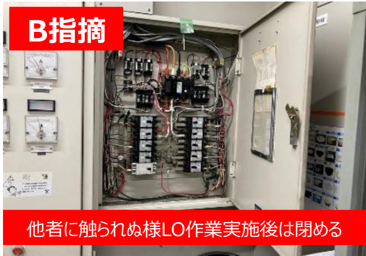
事例：分電盤扉解放のまま放置(充電部露出)
